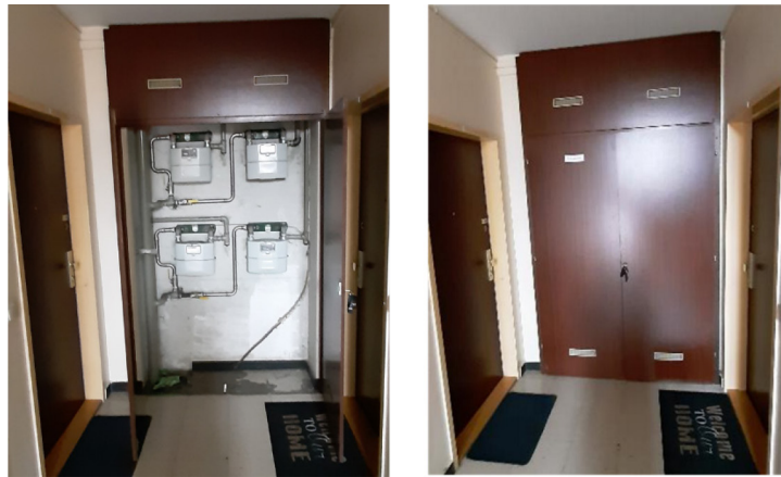
Bild 1: Gaszähler in Stiegenhaus
