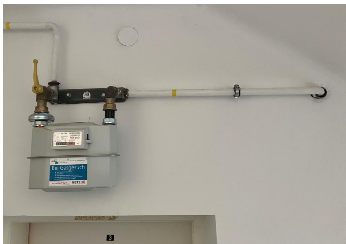
Bild 3: Gasleitung Wohnungseintritt (Brandabschnitte)
