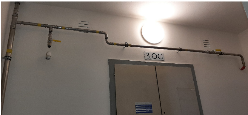
Bild 2: Gasleitung im Stiegenhaus
